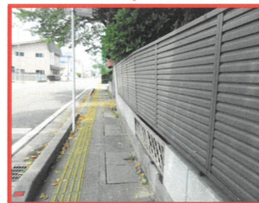
●斜めに傾いたフェンス (倒壊の恐れあり)
