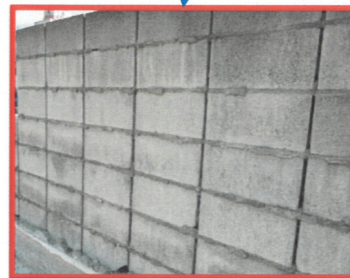
●施行に問題があり、不安定なブロック塀 (倒壊の恐れあり)
