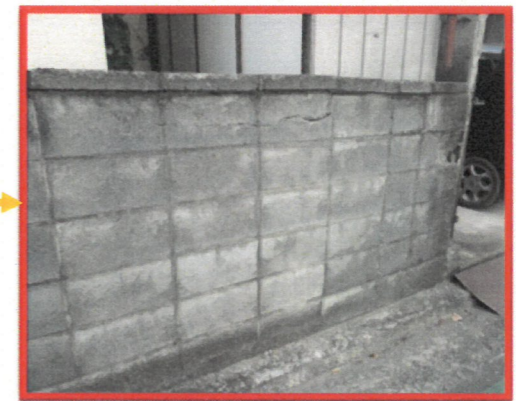
●ひび割れたブロック塀 (倒壊の恐れあり)
